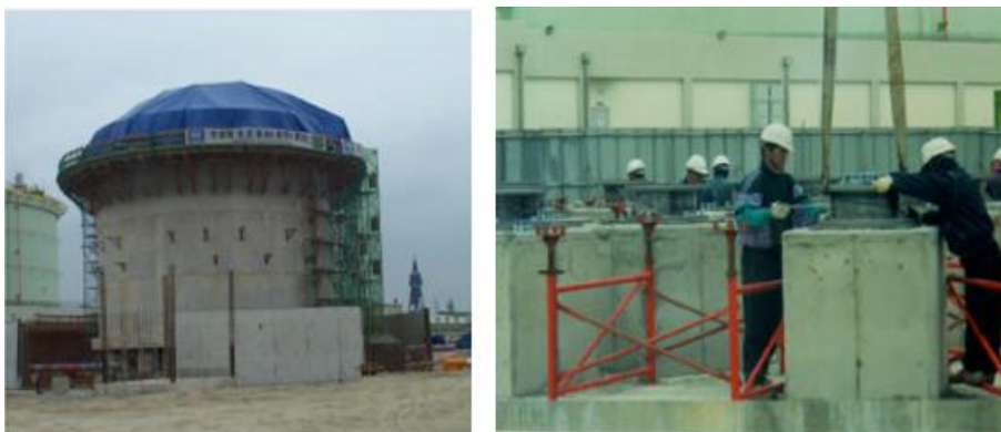
Figure 6 Pilot LNG tank
