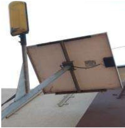
3.2.1) solar street light
