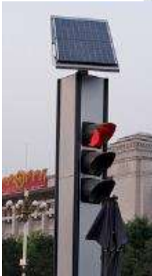
3.3.1) solar traffic light
