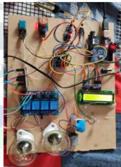
Fig.4. Actual installed setup.
