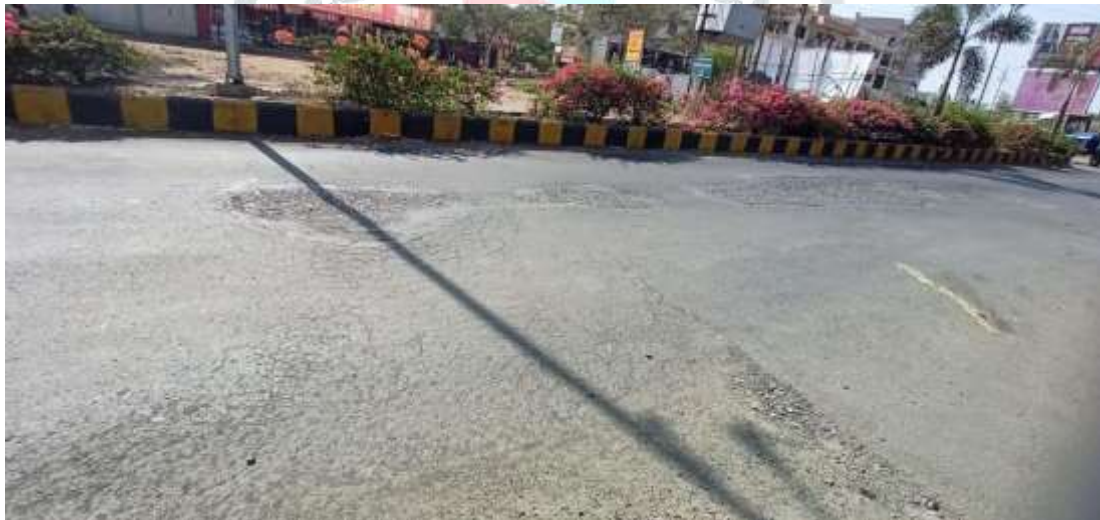
Fig: Alligator cracking
