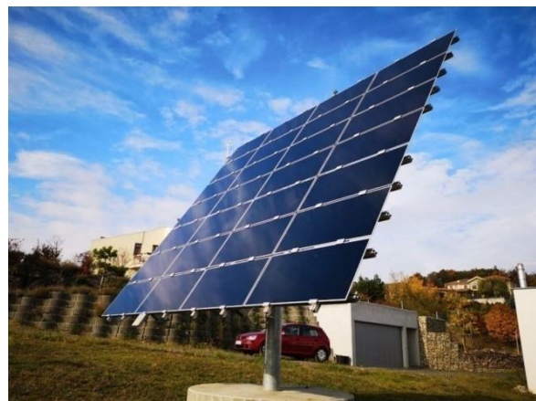
Fig:4 Solar panel
