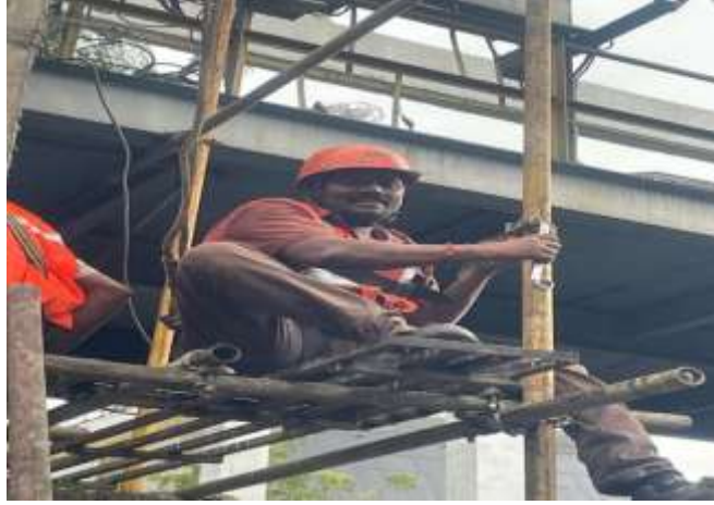
FIG 2 (d) LACK OF PPE
